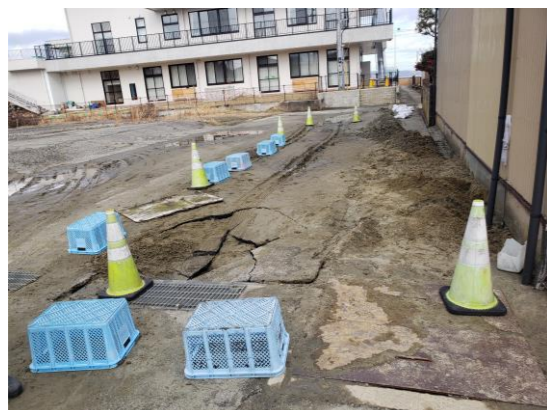
液状化により破損した道路
