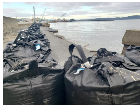
倒壊した防波堤
