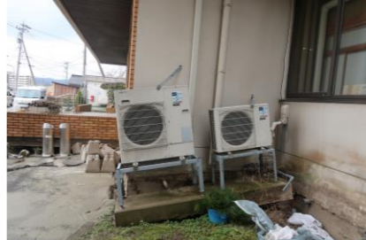
破損した室外機
