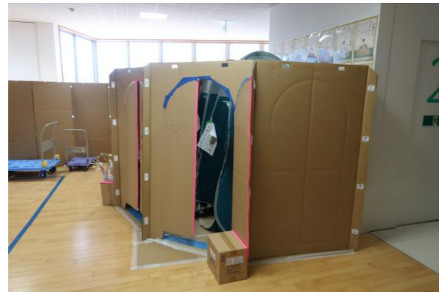
トイレ故障により簡易トイレ設置
