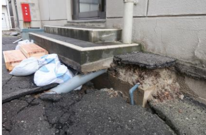
裏口周辺も地盤沈下
