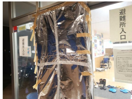
避難時に割った玄関ガラス
