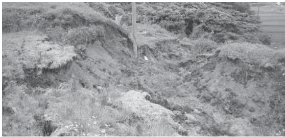
復旧が図られる7月豪雨災害現場（中島町地内）
