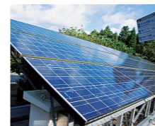
太陽光パネル
