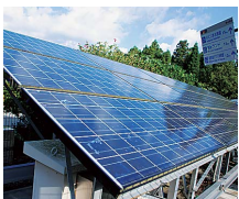
太陽光パネル
