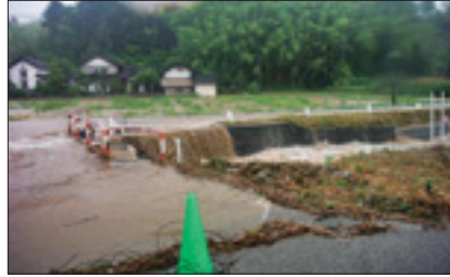
豪雨による被災状況
