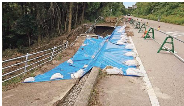
豪雨により道路が崩落
