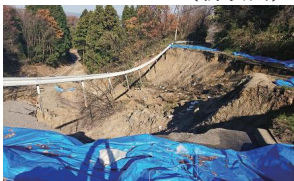
崩落した県道城山線
