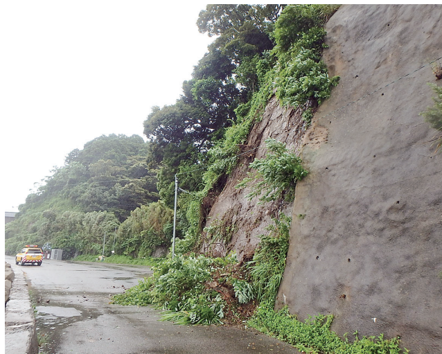
豪雨により法面が崩落
