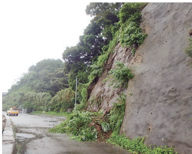
豪雨により法面が崩落
