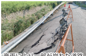
豪雨により一部が崩れた道路 (国分町地内)
