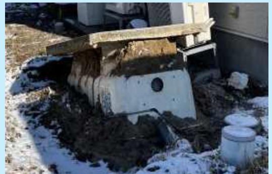
地震により浮き上がった浄化槽
