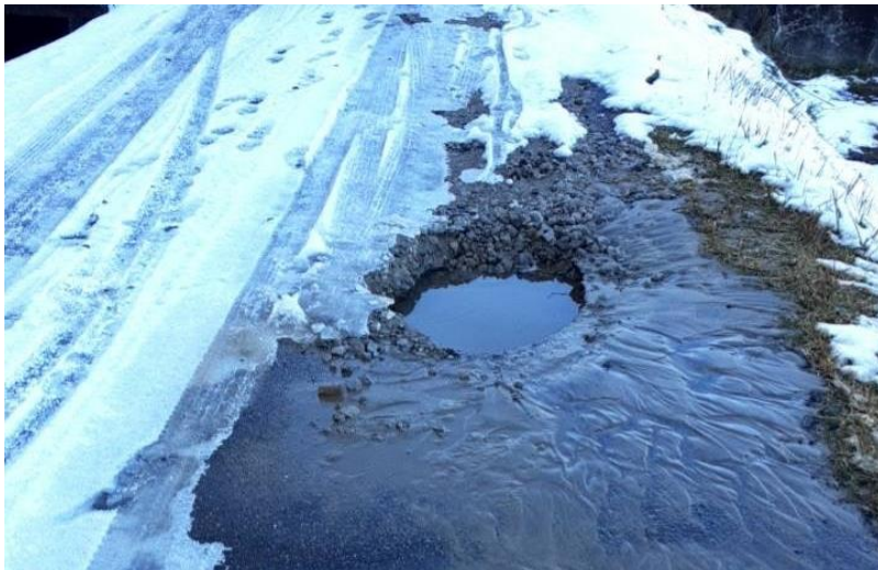
道路より漏水
