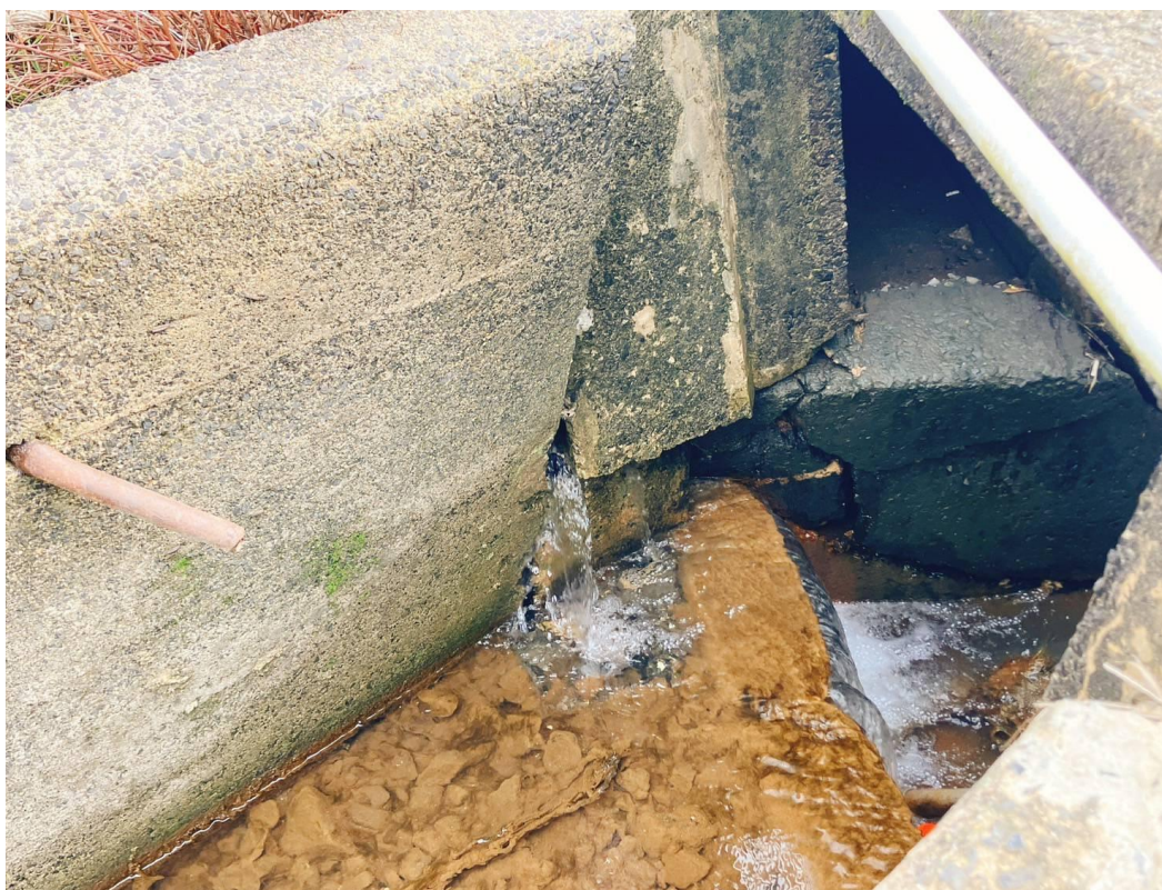
中島町外地内で新たな漏水箇所を発見しました。
