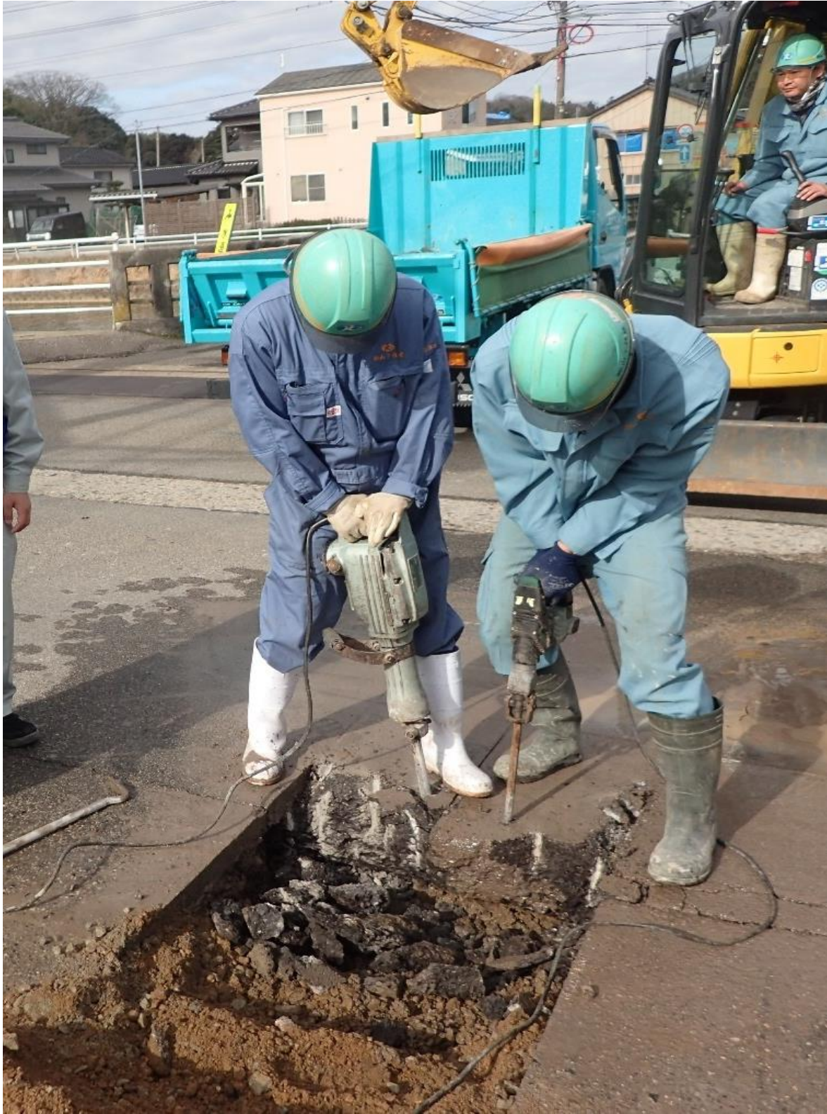
小島橋にて配管工事のため、舗装版の撤去をしました。（新潟市）
