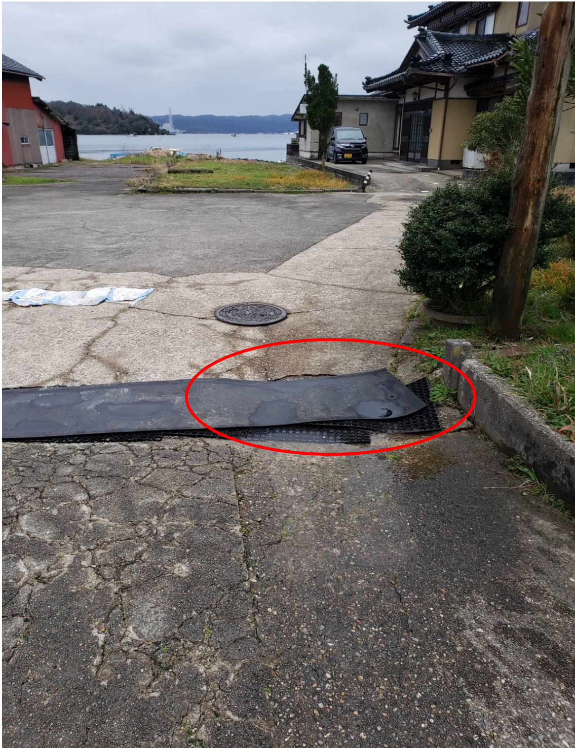
能登島須曾町地区で新たな漏水を発見しました。
