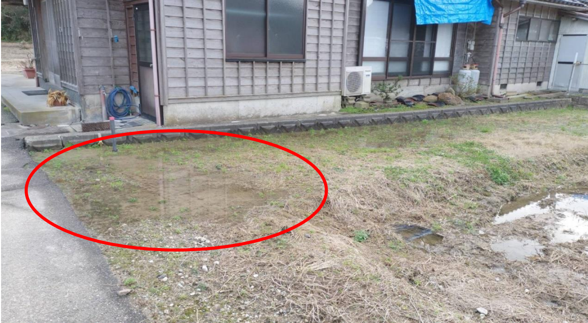
鵜浦町地内で新たな漏水を発見しました
