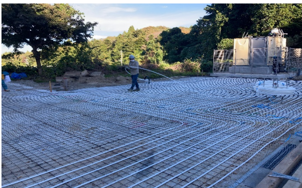
【写真①】ロードヒーティング配管状況
