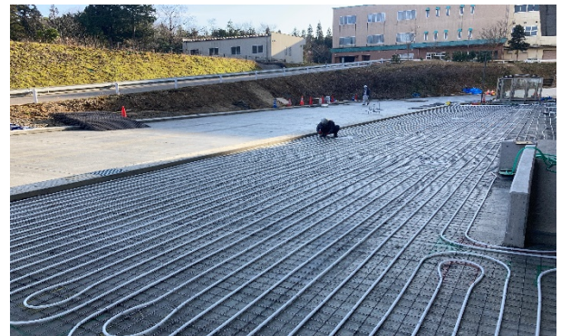
【写真②】ロードヒーティング配管状況
