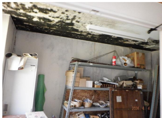
雨漏りによる天井、壁等の破損
