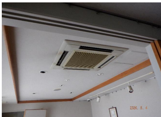
地震により空調設備損傷(天井埋込型)
