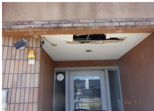
地震により正面玄関天井破損
