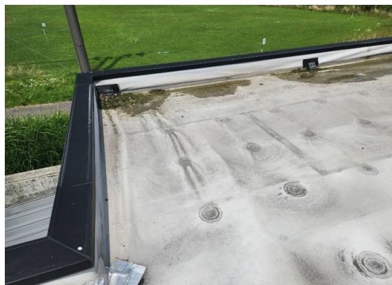
地震により屋上防水損傷(雨漏り有)
