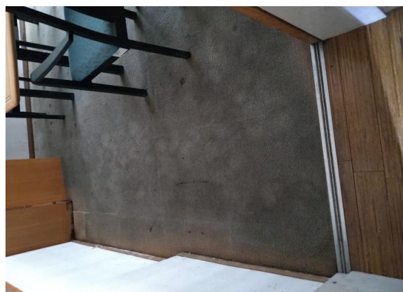
床下配管の破損による水漏れ(床水浸しの個室有)
