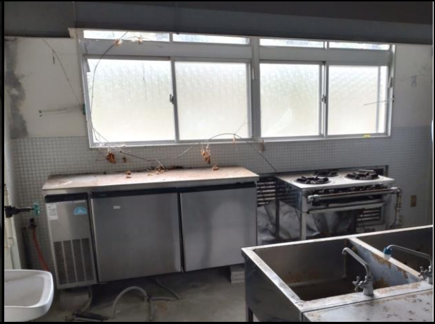
厨房内設備、壁等の破損
