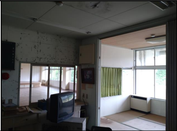
雨漏りあり、天井の破損
