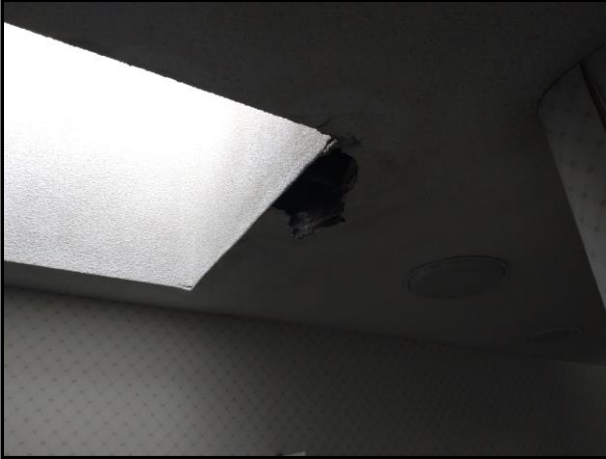
廊下天井吹き抜け横に穴
