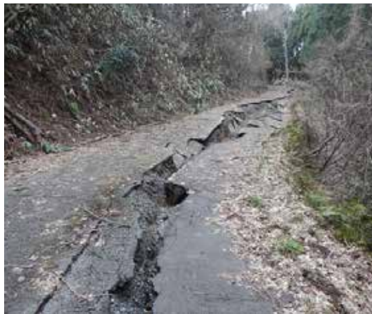
林道 | 道路崩落・(中島町別所))
