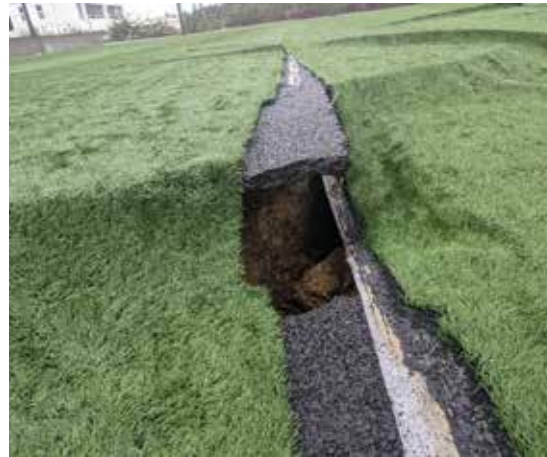
能登島グラウンド | 損傷 (能登島向田町)
