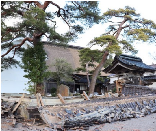
明治の館 | 外堀倒壊・内部損傷(中島町外)
