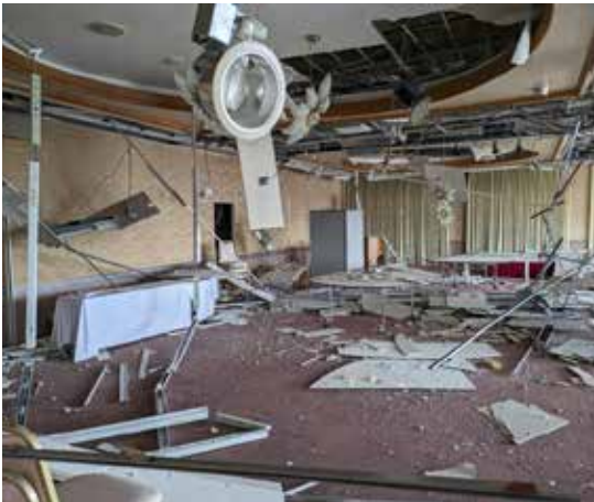
国民宿舎 能登小牧台 施設損傷 (中島町小牧)
