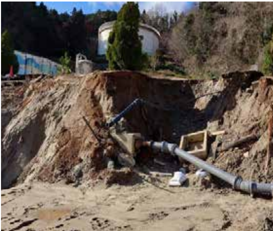
浄水場 | 施設損傷(藤橋町)
