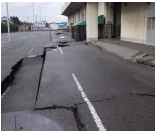
公設地方卸売市場 | 施設損傷(大田町)
