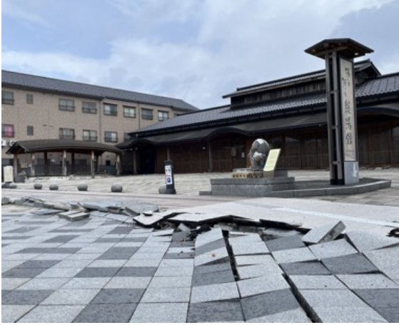
和倉温泉 | 道路破損・護岸破損 (和倉町)
