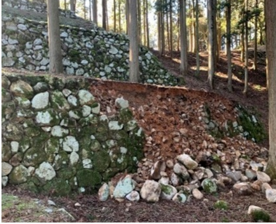
七尾城跡 | 石垣損傷・鳥居破損(古城町・古屋敷町)
