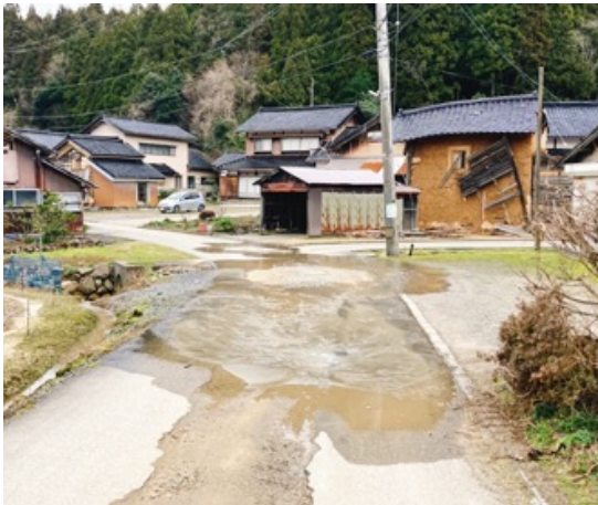
漏水・断水 | 水道管損傷(中島町深浦)
