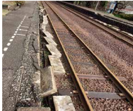
鉄道駅 | 駅構内損傷(中島町外)
