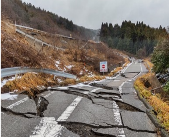
道路 | 道路崩落(左:中島町横田、右:能登島半浦町)
