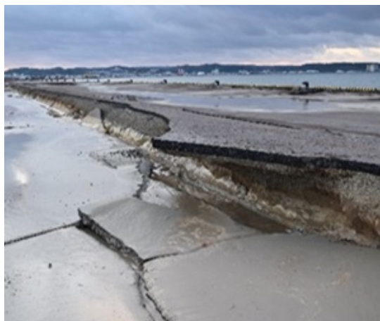
七尾港 | 舗装・岸壁損傷(大田町)
