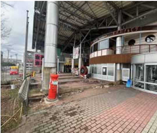
道の駅 能登食祭市場 | 施設損傷 (府中町)
