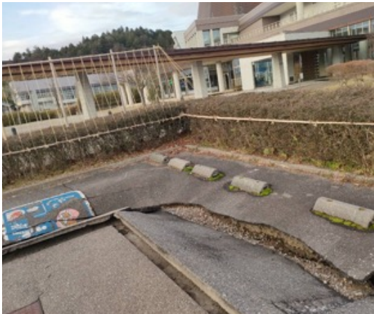
能登演劇堂 | 施設損傷(中島町中島)
