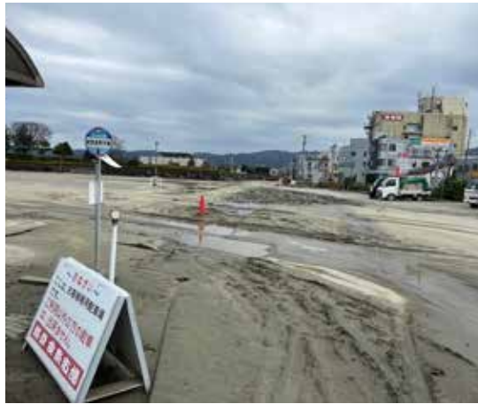
液状化 | 土砂噴射・舗装亀裂(府中町)
