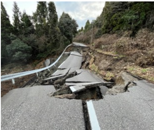
農道 | 道路崩落(能登島長崎町)
