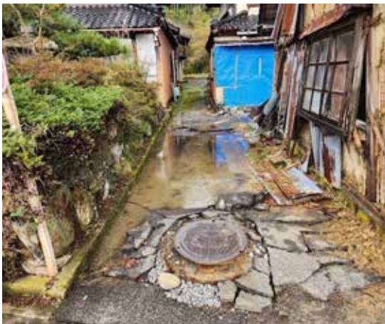
道路隆起 | 水道管損傷(能登島長崎町)
